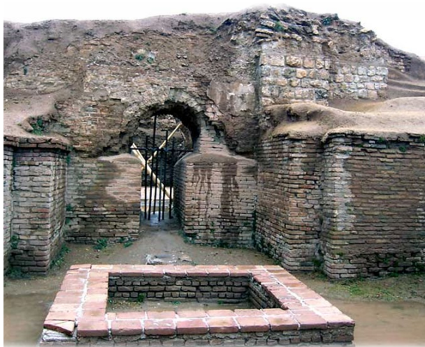
شکل ۱۴. از بالا به پایین تصاویری از رطوبت صعودی و نزولی ناشی از نزولات جوی بر روی دیوارها و کف بناها باعث سست شدن مصالح و ملاط‌ها و همچنین شرایط را برای رشد گیاهان و حضور جانوران فراهم می‌نماید. (عکس‌ها از آرشیو پایگاه تخت سلیمان)
